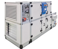
Havalandırma için klima santrali
